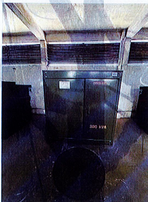
Fig. 8 Subestación Eléctrica #9 Tipo Pedestal de 300 KVA, 13,200-480/277 Volts.
