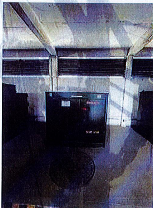
Fig. 5 Subestación Eléctrica #6 Tipo Pedestal de 300 KVA, 13,200-480/277 Volts.
