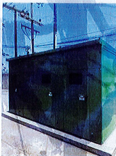
Fig. 3 Subestación Compacta para protecciones de los circuitos derivados en media tensión.
