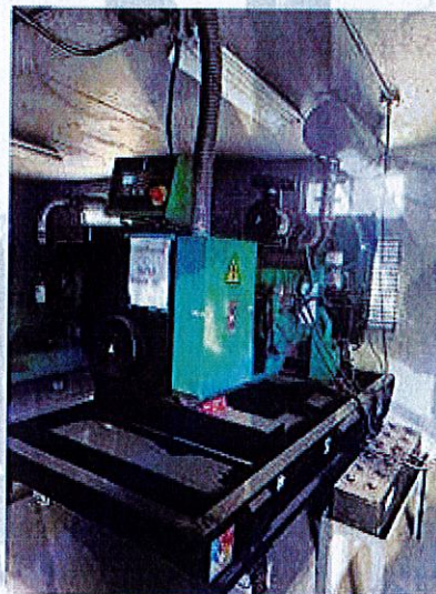
Fig. 10 Planta de Emergencia Trifasica de 100 KW, 480/277 Volts.
