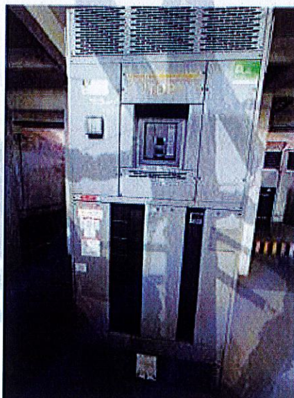
Fig. 9 Tablero de Distribución General de Subestación eléctrica #9, 480/277 Volts
